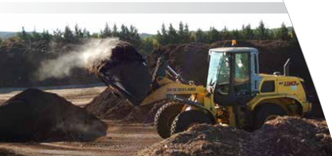
Chargeur sur une plateforme de compostage
